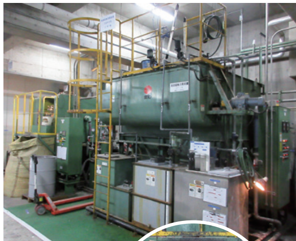
○廃水処理設備
