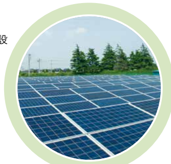
関東工場(勝田)の メガソーラー発電設備
