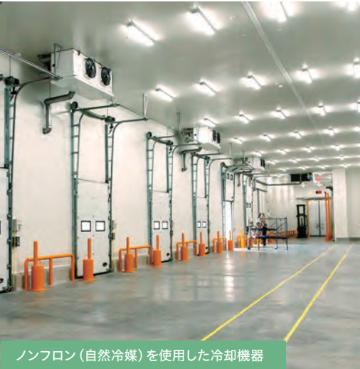
ノンフロンの冷凍冷蔵倉庫ではフロンガスを使用しないため環境負荷低減が可能
