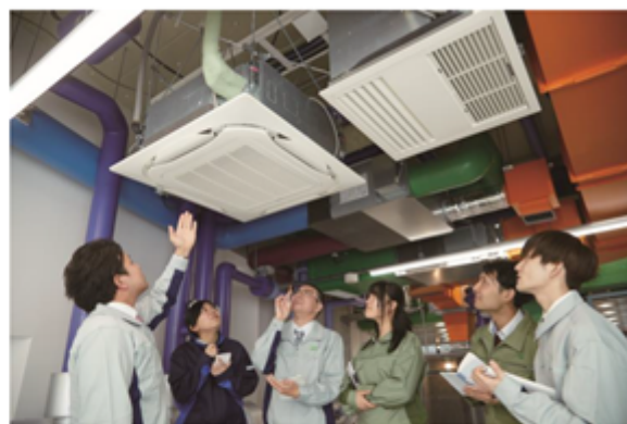
設備実習フロア
