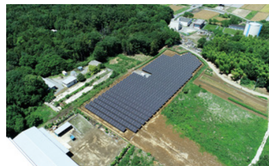
太陽光発電設備 埼玉県熊谷市
