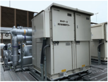
河川水利用ヒートポンプ
