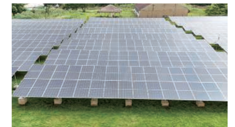
フジ オイル ガーナに導入した太陽光パネル
