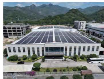
福建新烏龍飲料有限公司へ設置している太陽光発電パネル
