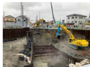
八潮市道路陥没の現場
