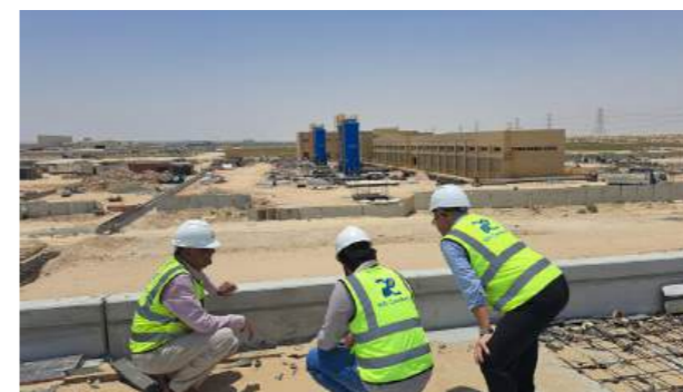
ドバイ ハサヤン送配水施設
