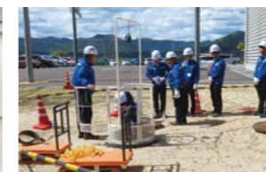
マンホール降下による地中線見学体験
