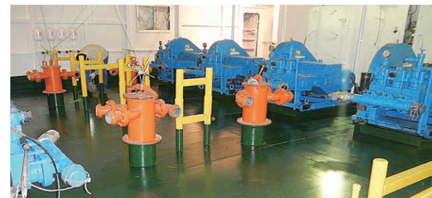
改装後のデコム7号機械室(右奥がプランジャーポンプ)
