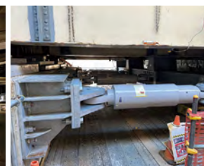
寒冷地仕様の制震ダンパー
