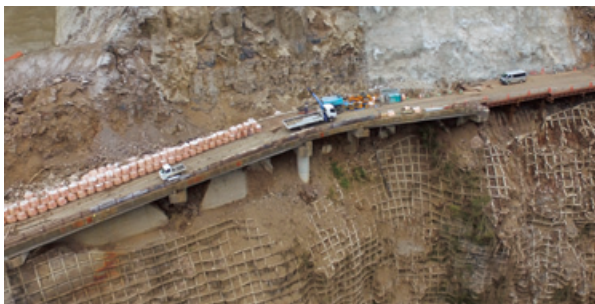
被災後の状況
