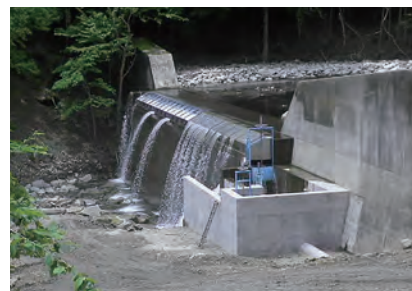
小水力発電取水設備
