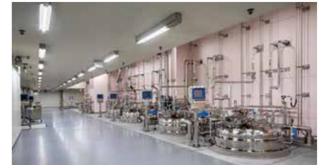
資生堂 大阪茨木工場 化粧水製造室(大阪府茨木市)
