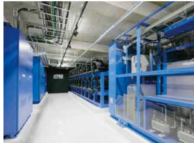
建物付帯型水素エネルギー利用システム「Hydro Q-BICs」 ※Hydro Q-BICsは、日本における清水建設(株)の登録商標です
