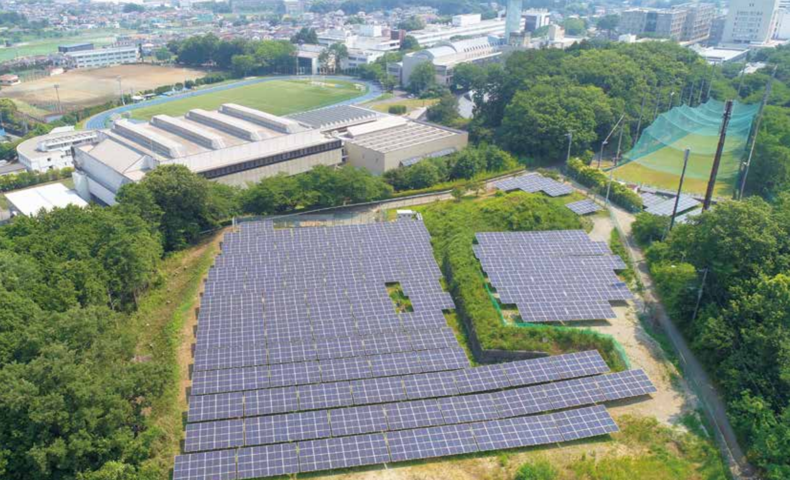
城西大学 キャンパス内太陽光発電PPA※1 (埼玉県坂戸市)
