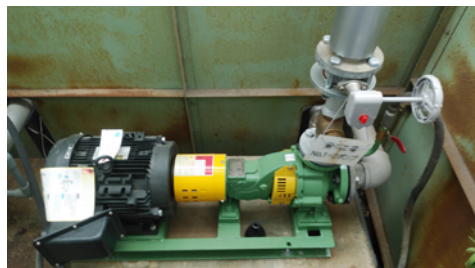
高効率冷却水ポンプ(KSオークラ本社工場)
