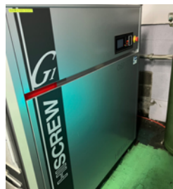
コンプレッサー更新及び台数制御 (KSオークラ静岡工場)
