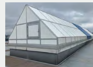
遮熱塗装を施した天窓
