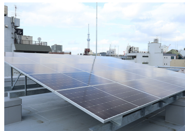
本社屋上のソーラーパネル
